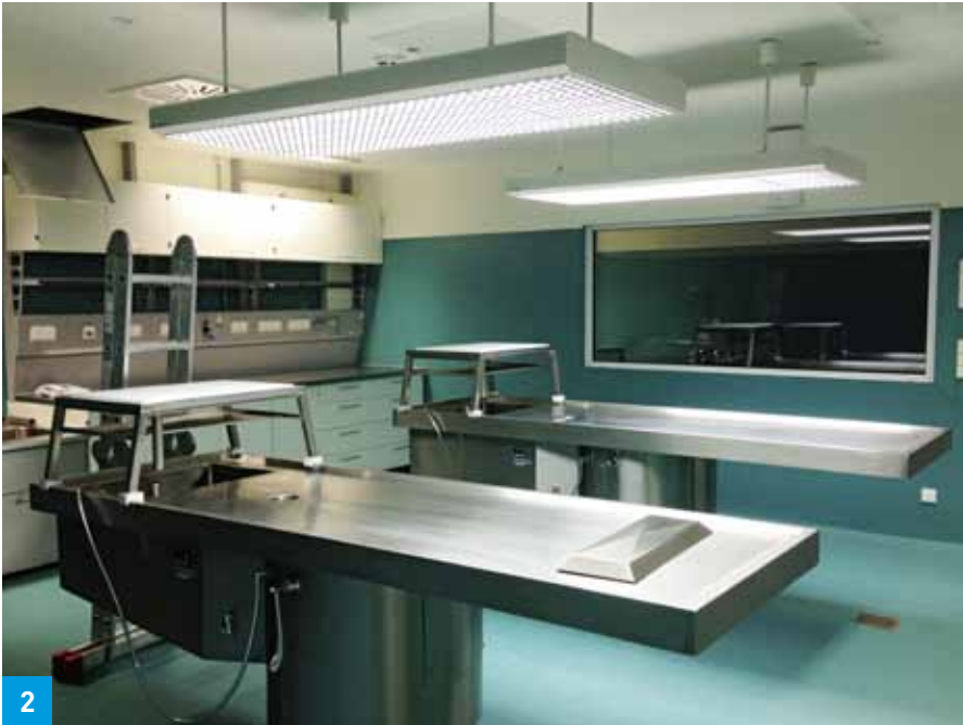
Wasseranschlüsse zu medizinischen Einrichtungen oder Pathologie, müssen immer gegen Flüssigkeitskategorie 5 abgesichert werden und dürfen keine unmittelbare Verbindung zum Trinkwassernetz haben.
